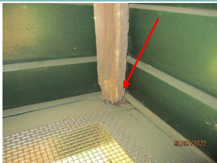
Ligger in hoek wat gerot. Onderreinde spantpoot idem/ verweerd/ gescheurd.
