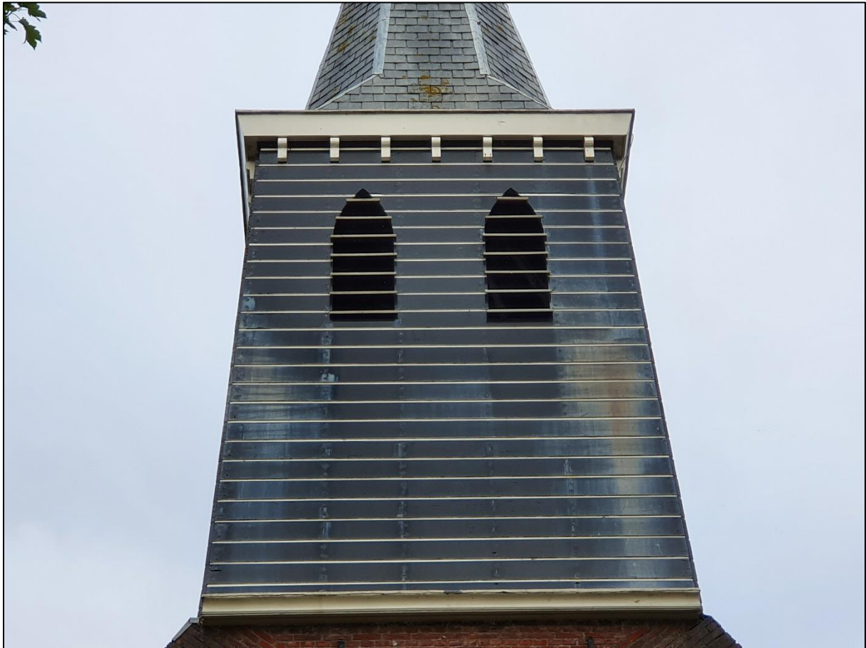
Figuur 1.: Het houtwerk van de toren van de kerk zal worden vervangen.
