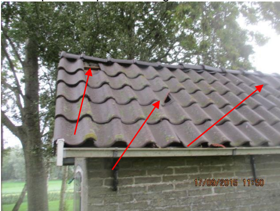
Uitgezakt dakpannen en kapotte dakpan.
